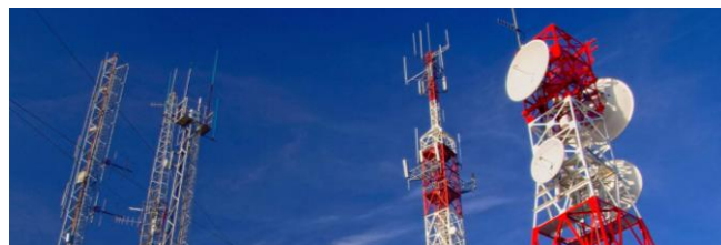
«Абсолют: SmartSite». Мониторинг ДГУ: Операторы мобильной электросвязи ряда стран СНГ
